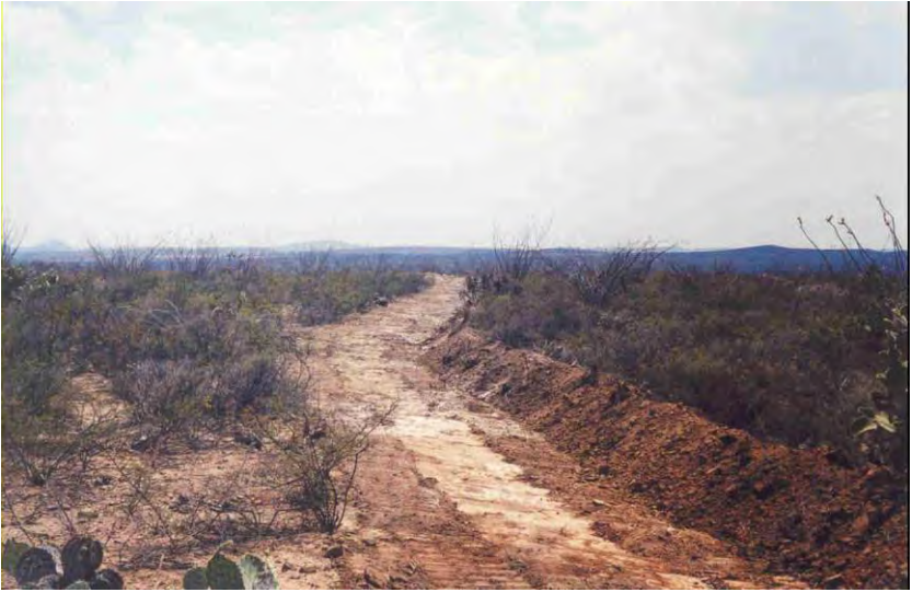
Figura 16. Bordo a nivel recién construido en donde posteriormente, fue sembrado una mezcla de pasto Banderilla en el talud del mismo, en un matorral mediano subinermes en la Unidad MIRZA del Ejido de Río Grande, Zac. Primavera del año 2002.
