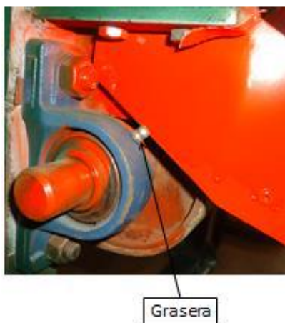
Figura 22. Grasera la chumacera del rodillo en la parte final de la banda transportadora.
