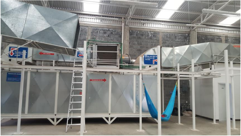
Figura 3. Túnel solar. Planta termosolar deshidratadora de productos agrícolas del estado de Zacatecas.
